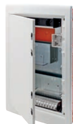
Rozvodnice Centro Stella
